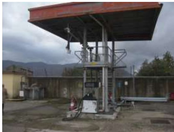
Foto n. 8: pensilina da carico con erogatori
