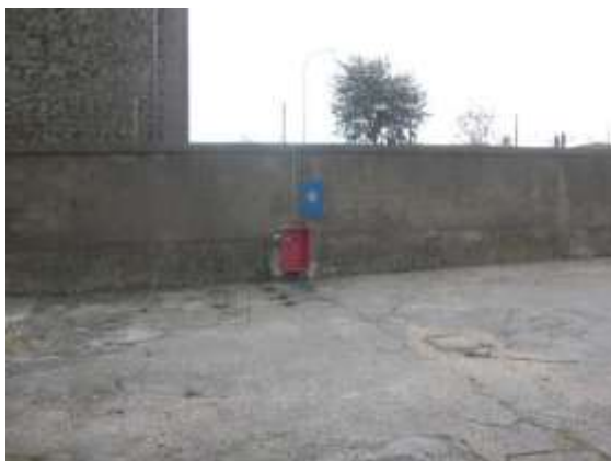
Foto n. 11: cassetta attacco idrante
